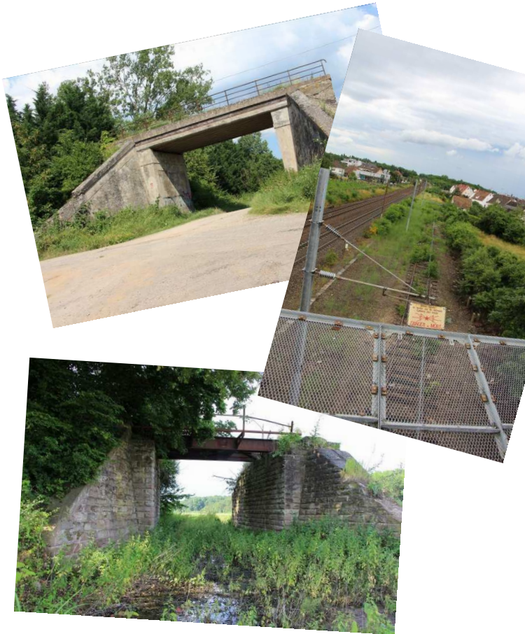
Ponts près de l'émetteur et près de la station d'épuration en 2016 et voie ferrée depuis le pont du Sand à Sélestat
